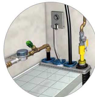
Kompakte und platzsparende Installation der Haus- und Netzanschlüsse und dazugehöriger Anschlusseinrichtungen
