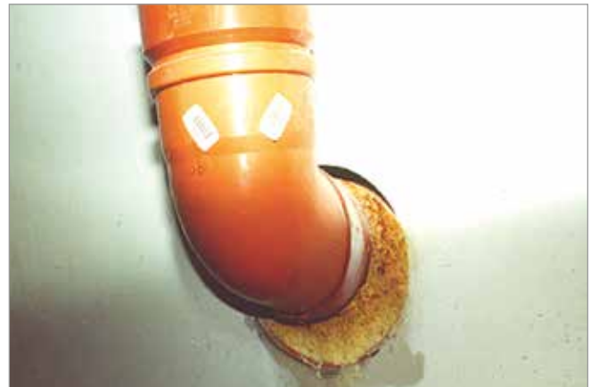
③ Wasserdurchlässige Dichtungsmaterialien bzw. fehlende Adhäsion (Beispiel 1)
