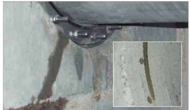
① Riss in Kernbohrung/durchtrennter Bewehrungsstahl
