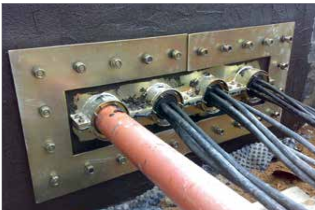
⑧ Sonderkonstruktion zur Einbindung mehrerer Leitungen in einer Los- und Festflanschkonstruktion
